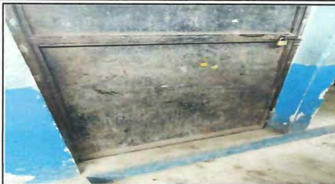
Foto 1: Las puertas de aulas necesitan mantenimiento y aplicación de pintura.
