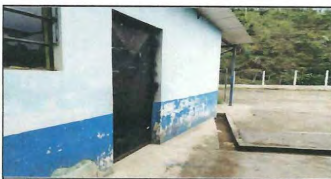
Foto 6: Las paredes necesitan aplicación de pintura (interior y exterior)
