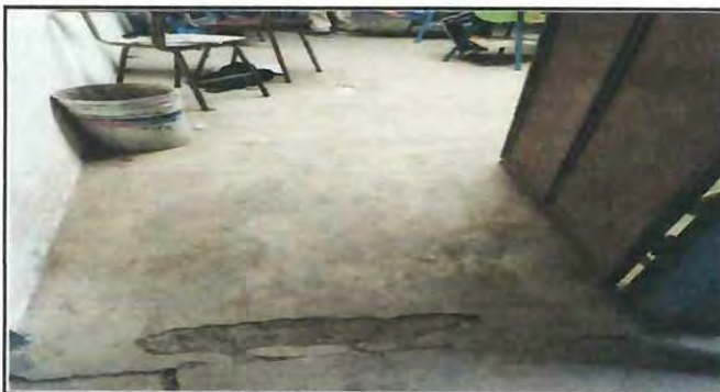
Foto 3: Las aulas no cuentan con piso cerámico, sino que solamente entortado.
