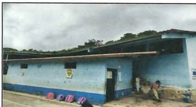
Foto 4: El entechado no cuenta con bajadas de agua pluvial.
