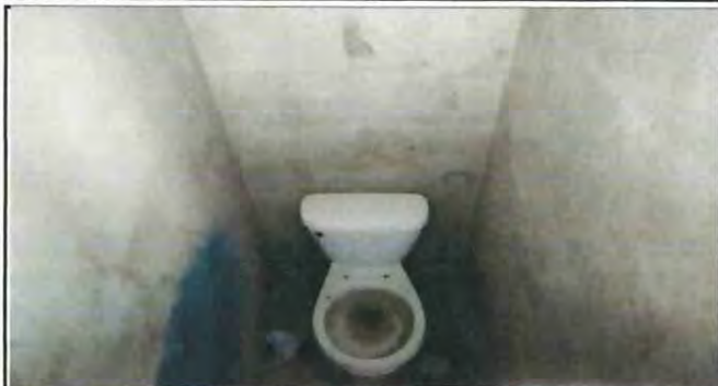
Foto7: Se sustituirán los inodoros ya que están en mal estado y aplicación de pintura a puertas de sanitario.
